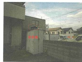
図-14 受信機の設置状況
