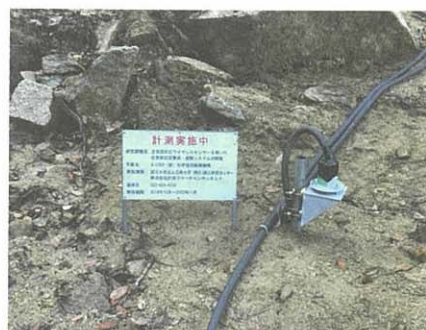
図-11 溪流の地盤内に打ち込んで設置した土石流センサー
