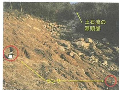
図-12 溪流の地盤内に打ち込み設置した土石流センサーと溪流内の位置(測点5)
