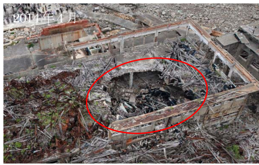
図6 会社事務所スラブの崩落
