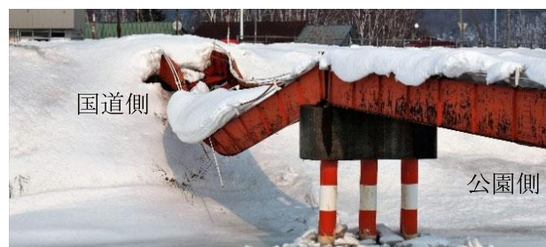
a) 主桁の変形 (2019 年)
