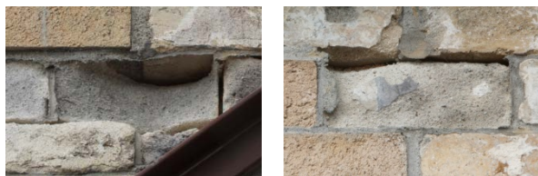
図1 表面劣化の進行した煉瓦
