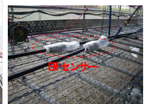
写真-8 EMセンサー（ケーブル設置前）
