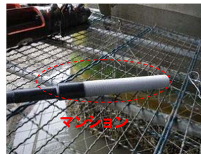
写真-5 ケーブルマンション部
