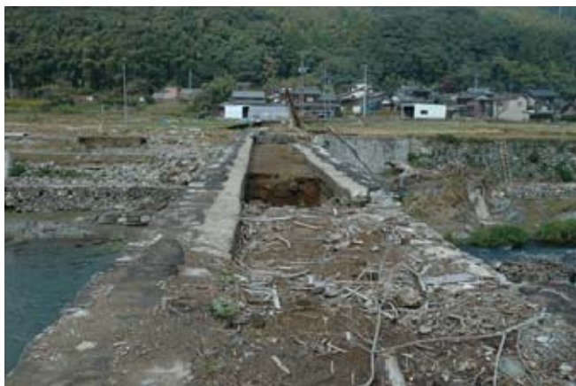
写真-1 被災後（橋面）
