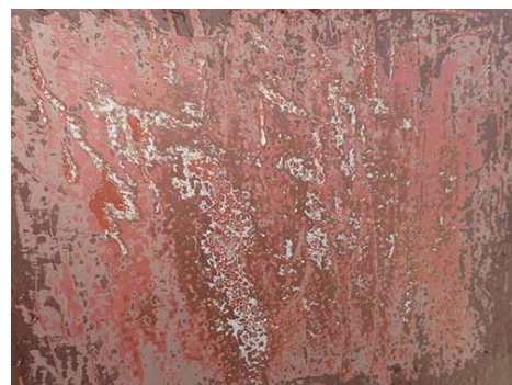
塗膜剥離状況
